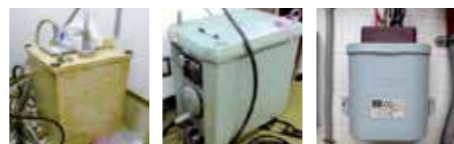
X線発生装置 電気溶接機 低圧コンデンサー 非自家用電気工作物の例 (写真は低濃度PCB廃棄物早期処理情報サイトより)
