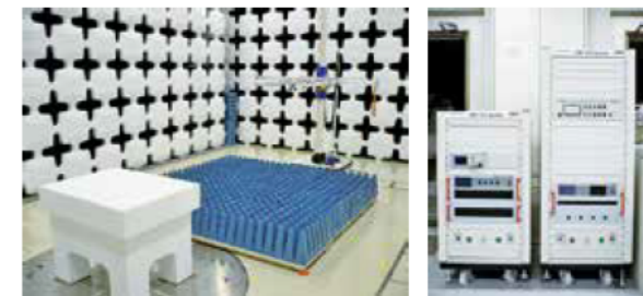
電波暗室(左)と強電磁界用パワーアンプ(右)
