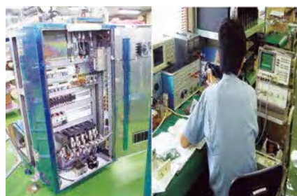
ユニットから制御盤まで組立・配線・調整・検査
