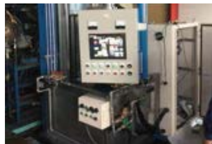
サーボモーター式高周波装置
