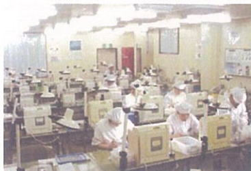
クリーンルーム（クラス10000）：88㎡
