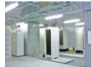
勝島タワーマンション内MDF室
